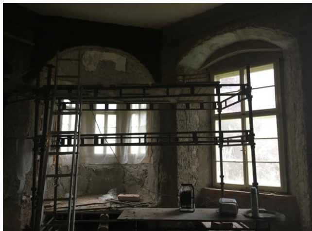
Místnost 2.06 před opravou
